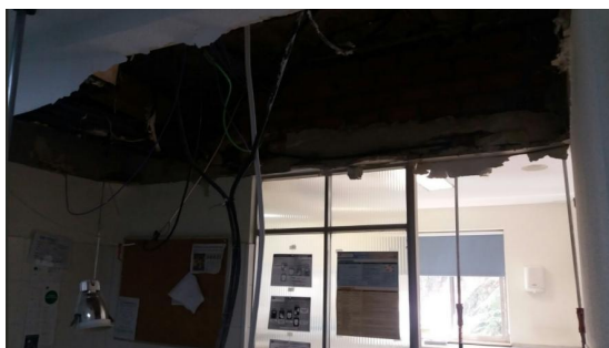
Desprendimiento del techo de una sala de extracciones del hospital
